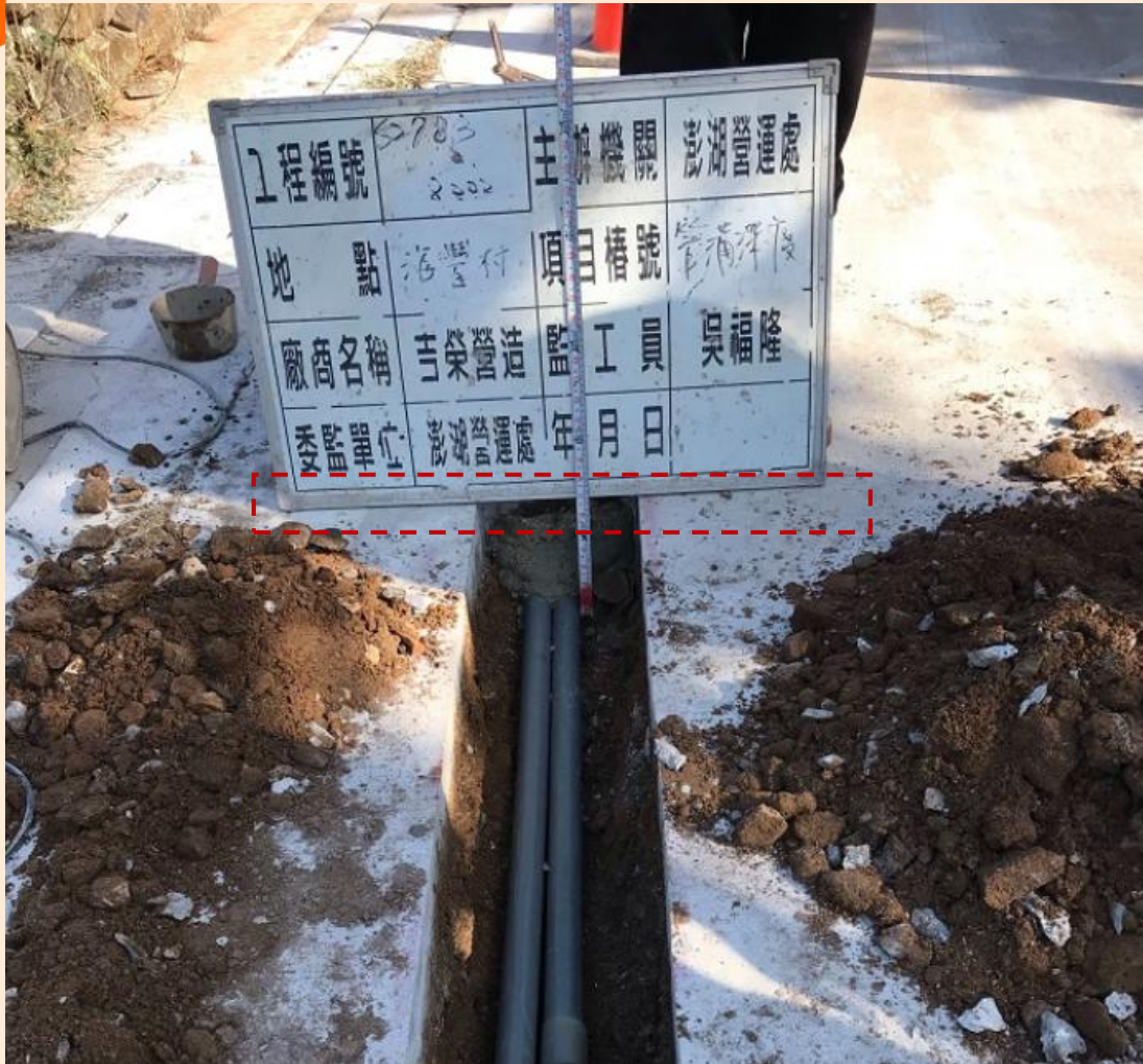
量測數據模糊不清且未放置水平箱尺
